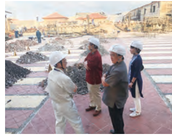
首里城火災現場視察
